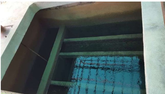
Figura 24: Estação de Recalque de Água Tratada
