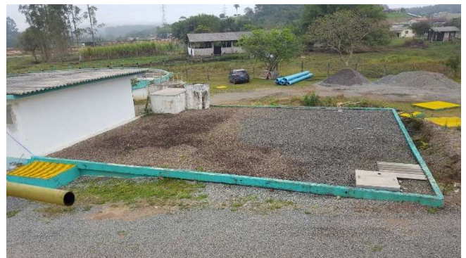
Figura 25: Estação de Recalque de Água Tratada
