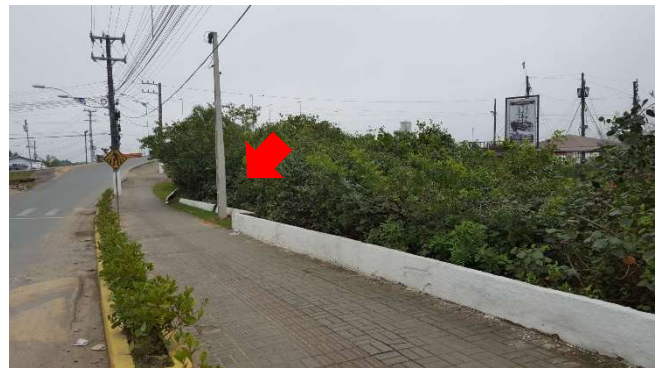
Figura 31: Macromedição de entrada.
