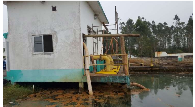
Figura 23: Tanque de contato para pós-cloração
