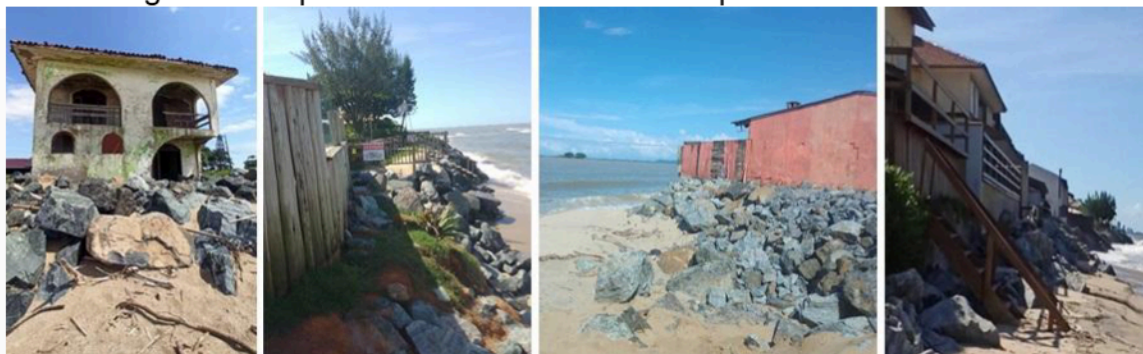
Figura 4 - Impacto da erosão costeira nas praias de Barra Velha
